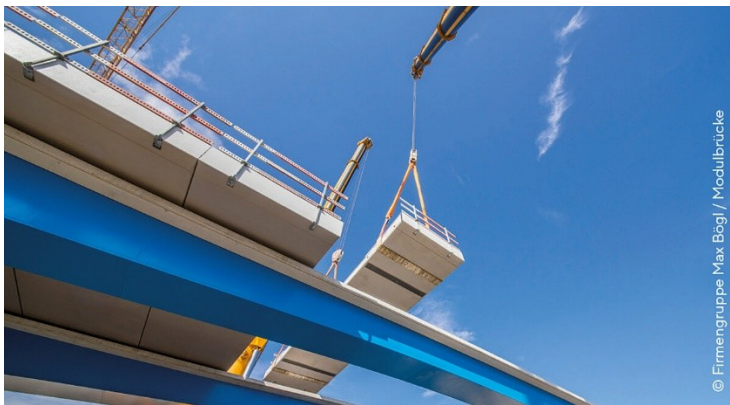
Firmengruppe Max Bögl / Modulbrücke
